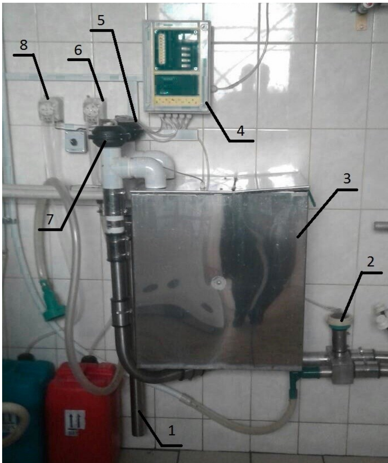
Рисунок 1 - Встановлений на фермі автомат промивання для доїльних установок АПДУ-1; 1 - зливна труба, 2 - електроклапан подавання повітря, 3 - бак для автомата промивання, 4 - блок управління автоматом промивання БУСП-1 або БУАП-04, 5 - електроклапан забирання води, 6 - дозуючий насос для лужного засобу, 7 - електроклапан для забезпечення циркуляції-зливу, 8 - дозуючий насос для кислотного засобу.
